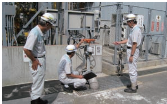
防液堤排水泵检查(王子制纸株式会社 富冈工厂)
